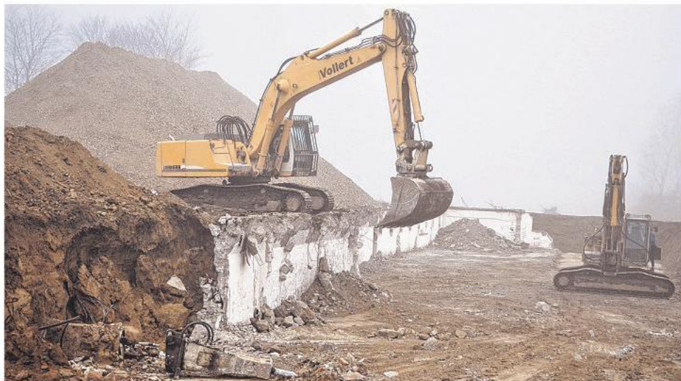
Die Abbrucharbeiten an der Sandkoppel sind in vollem Gange – auch bei Morgennebel legen die Bagger die Bunker frei. KÖHLER
